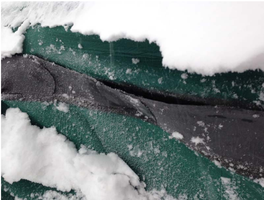
【接合部の剥がれ】
